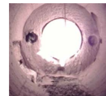
写真4-5. ブローアップ運転中燃焼炉内
