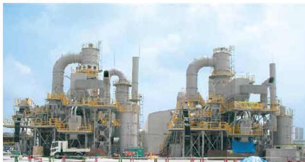
油汚染土壌浄化プラント
