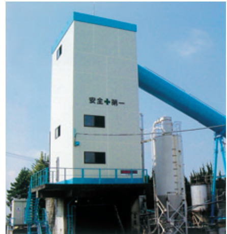
群馬で稼動中の高性能コンクリートプラント「DASH-225」
