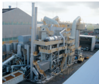
神奈川で稼働中のリサイクルプラント 「NRP-100」
