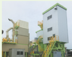
石膏系固化工材製造設備
