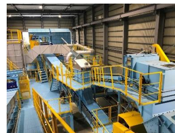
破碎プラント
