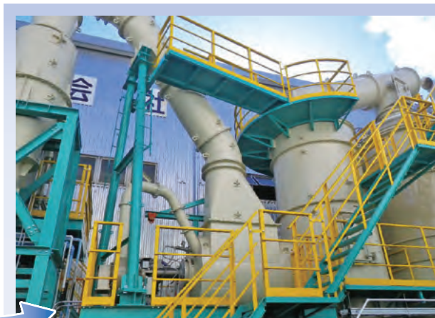
レアメタル回収用廃バッテリー焼成設備
