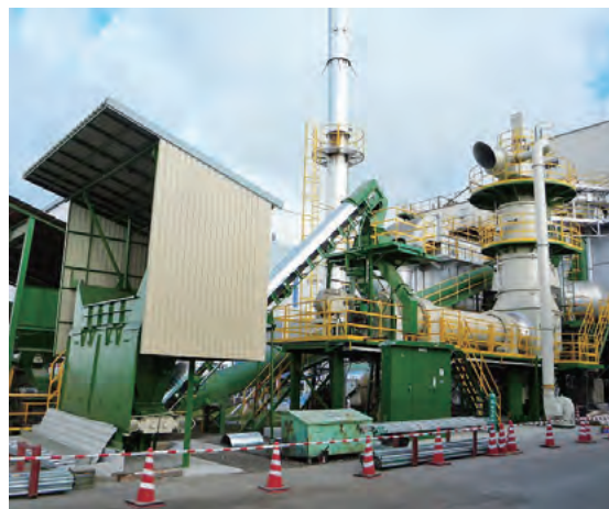
バイオマス固形燃焼システム
