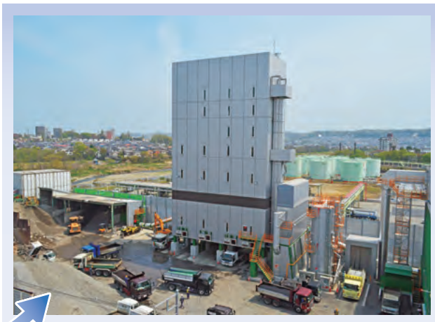
東京都で稼働中のアスファルトプラント NAP・EBD-1608-9351D
