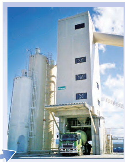
福井県で稼働中のコンクリートプラント DASH-N225EvoⅢ130R-ITBP
