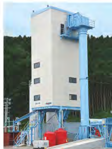
宮城県で稼働中のコンクリートプラント DASH-N225EvoII-110TTRI
