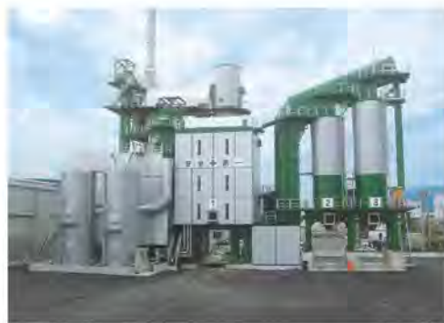
広島県で稼働中のアスファルトプラント ABD-1600MBN+TOPα60-50AL
