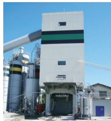
長野県で稼働中の バッチャープラント DASH-225 EvoⅢ130R-TRI
