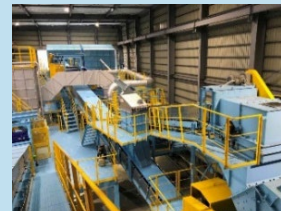
破碎プラント
