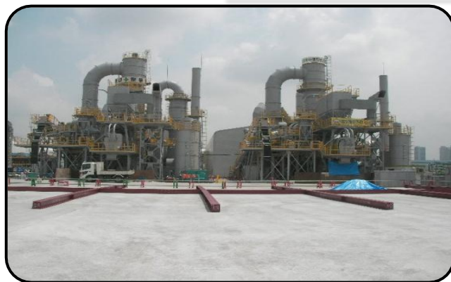
豊洲新市場建設予定地で稼働中の 油汚染土壌浄化処理プラント NTR-StageVI
