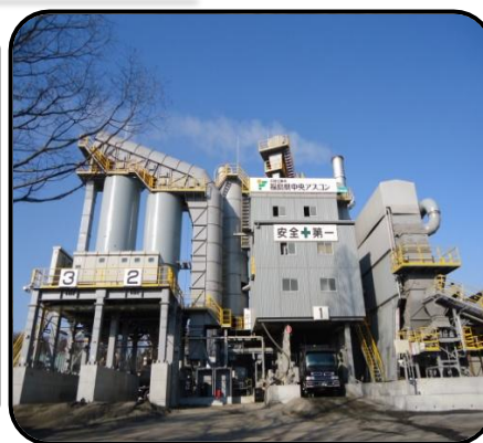
福島県で稼働中の アスファルトプラント ADB2000+NRUE90
