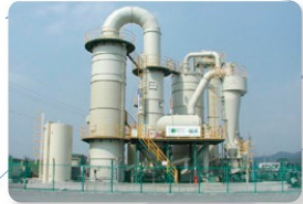
土壌浄化プラント (環境及び搬送関連事業)
