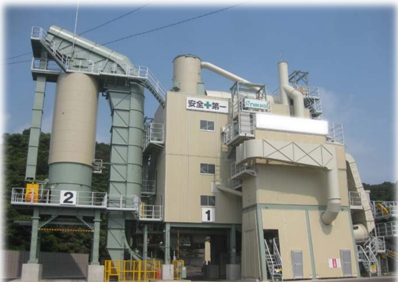
(アスファルトプラント/長崎県)
