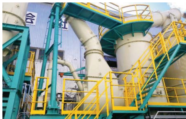
レアメタル回収用廃バッテリー焼成設備
