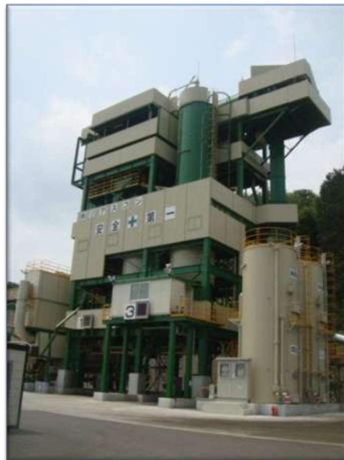
宮城県で稼働中のアスファルトプラント ユーロAP
