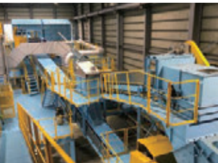
破碎プラント
