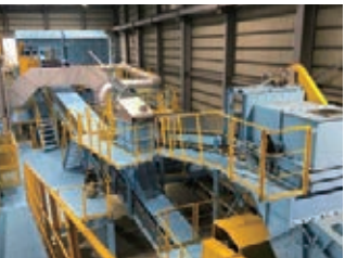
破碎プラント
