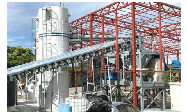
写真6: 縦型サイロ+セメント計量スクリュー
