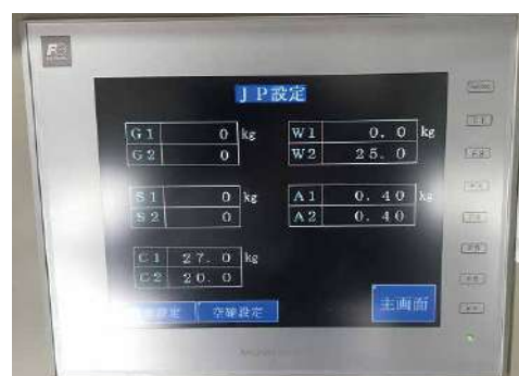
写真7:動力操作盤面の表示
