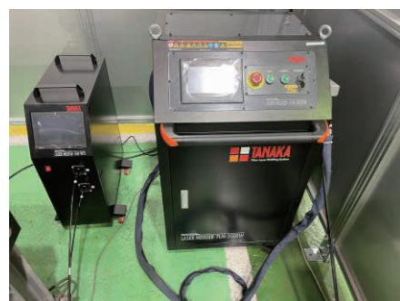
写真4 設置状況 本体 左側:ワイヤ送給 右側:ファイバー溶接機本体
