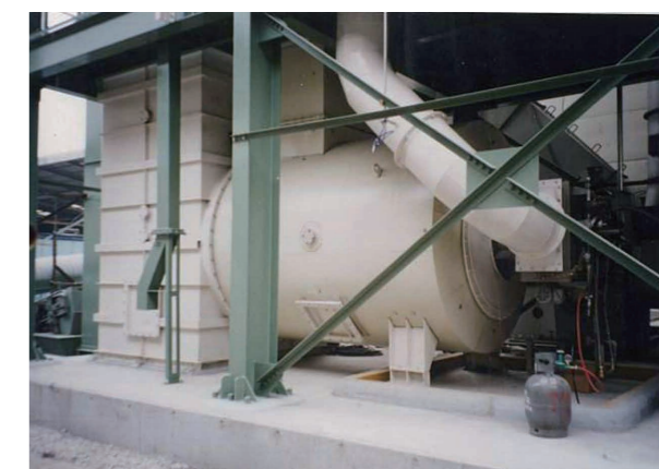
写真-3 直接燃焼式脱臭装置の燃焼室
