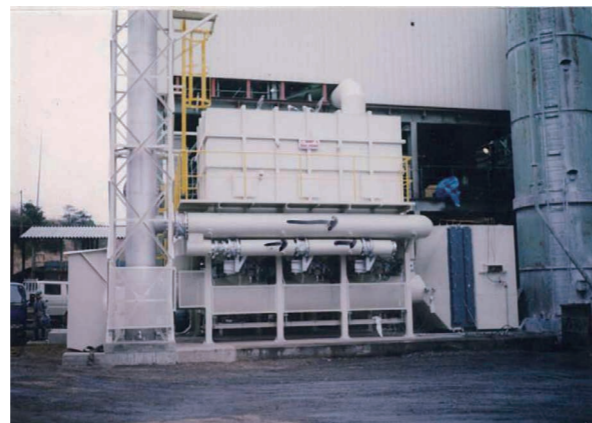
写真-4 蓄熱燃焼(RTO)式脱臭装置の全景
