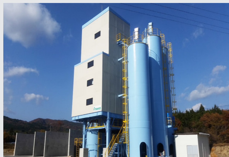
【灰テックビーズ製造プラントの一例】
