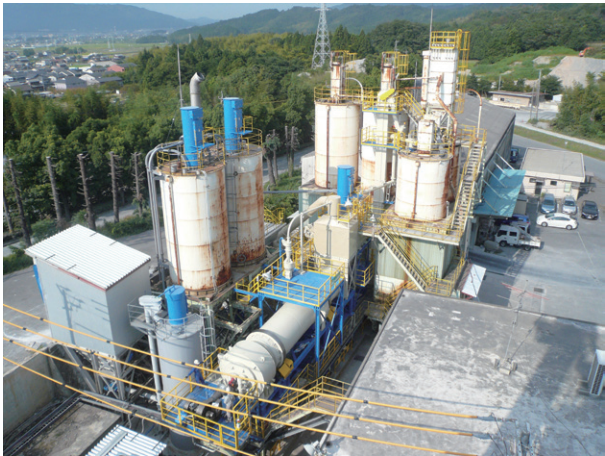
写真-7 II型無水石膏製造装置の全景
