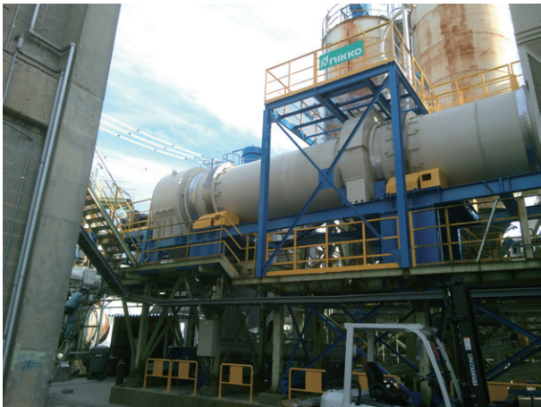
写真-8 II型無水石膏製造装置のロータリーキルン
