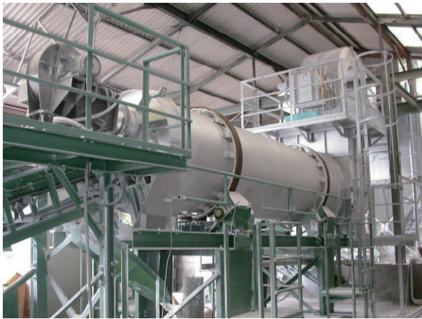
写真-5 定置式のロータリーキルン 2)
