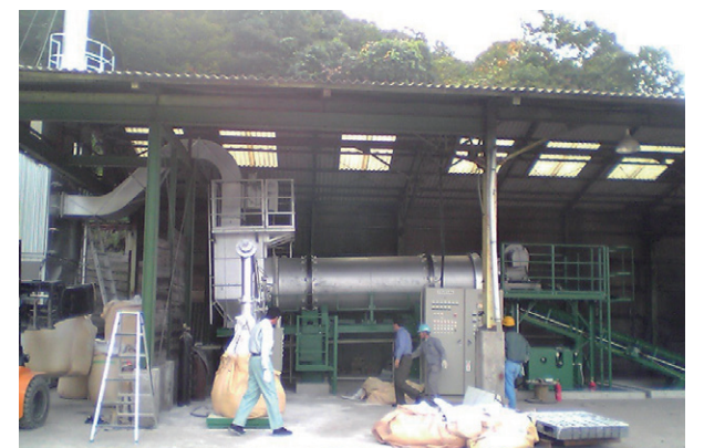
写真-2 定置式半水石膏製造システムNPR-400の全景
