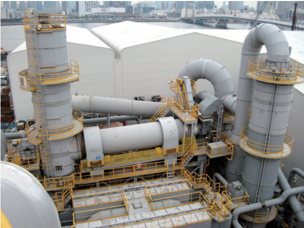
写真-1 本研究で開発した油汚染土壌浄化システム
