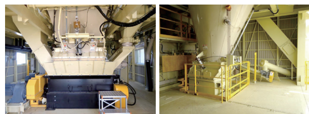
資料A「ミキサ、サージビン一連接続の様子」
