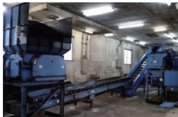
資料J「破袋機、破袋補助コンベヤ、傾斜コンベヤ」 破袋機、破袋補助コンベヤは2012年3月納入
