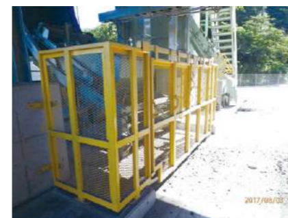
写真2 スキップエレベータ安全柵
