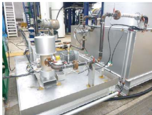
写真2 アスファルト供給装置
