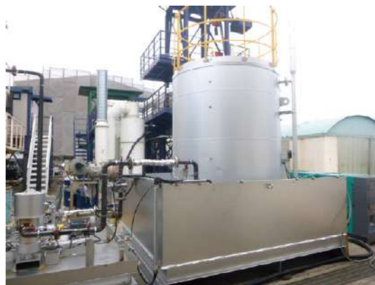
写真1 アスファルトタンク
