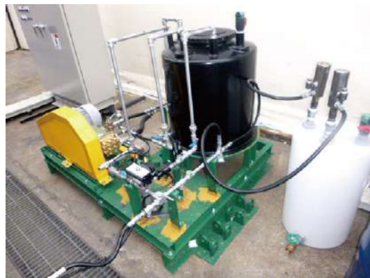
写真3 水ポンプユニット
