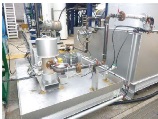
写真2 アスファルト供給装置
