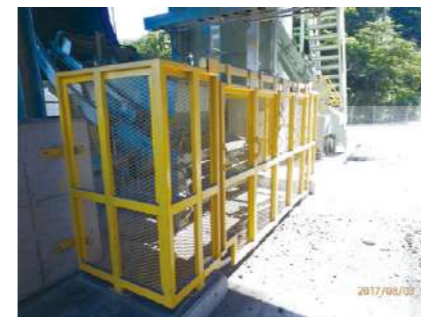
写真2 スキップエレベータ安全柵
