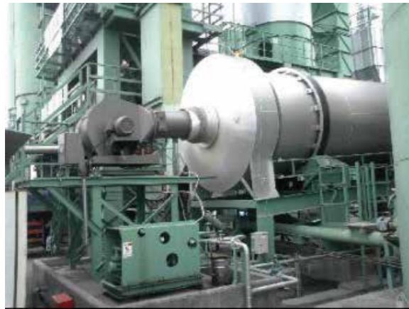
写真-6 現在型APの骨材乾燥システム
