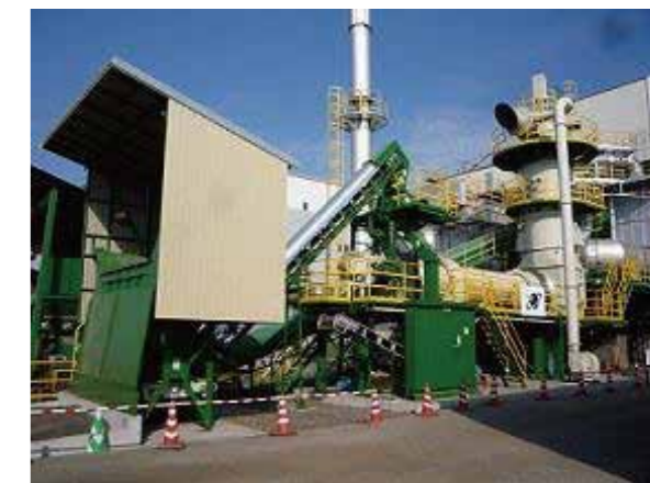
写真-18 固形バイオマス燃焼システムの全景
