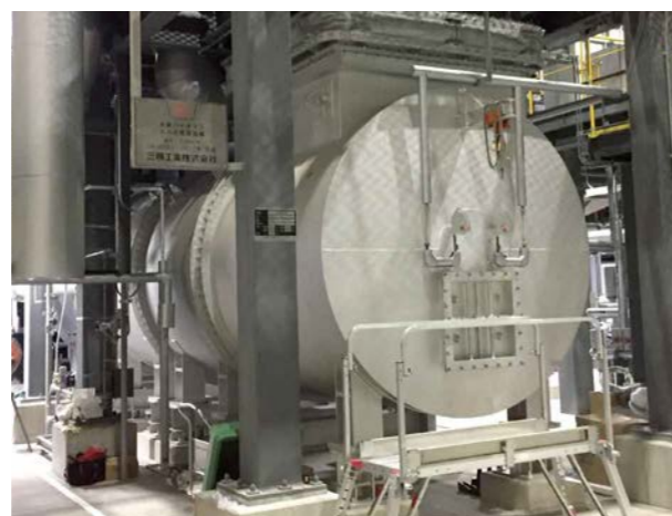
写真2-1. タール燃烧炉
