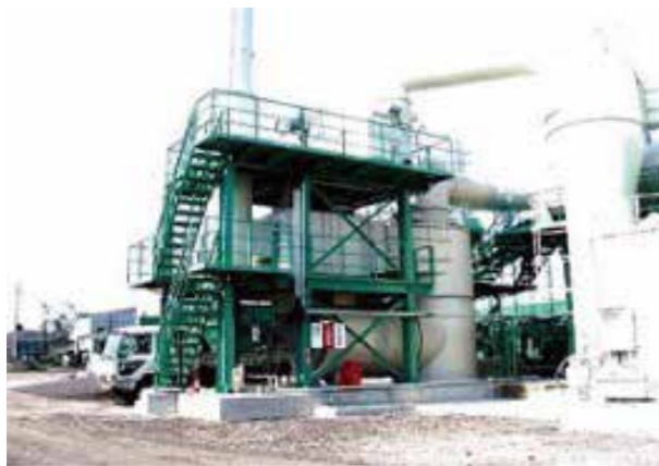
写真-13 直接燃焼方式の脱臭装置
