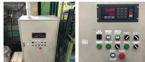
図6 制御盤全体 図7 制御盤操作部
