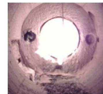
写真4-5. ブローアップ運転中燃焼炉内
