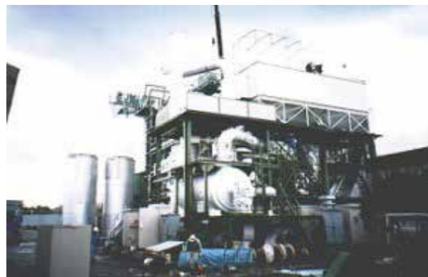
写真-14 RAVコンビネーションシステム1号機の全景
