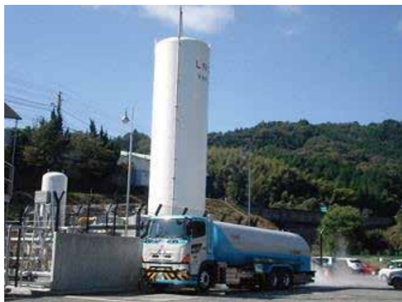
写真-15 LNGサテライトシステムの全景
