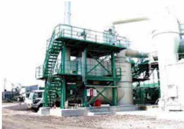
写真-13 直接燃焼方式の脱臭装置
