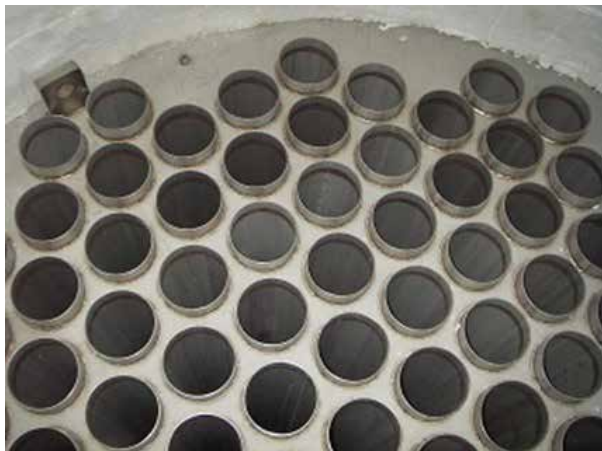
写真-19 熱交換器上部(チューブ内部に放熱側ガスが流入)
