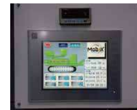
動力操作盤 盤面
