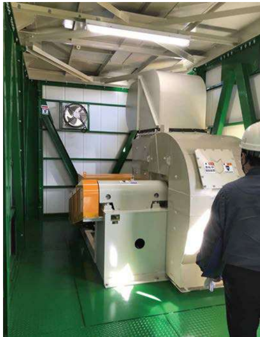
写真7 バグ架台(2F部分)内の排風機
