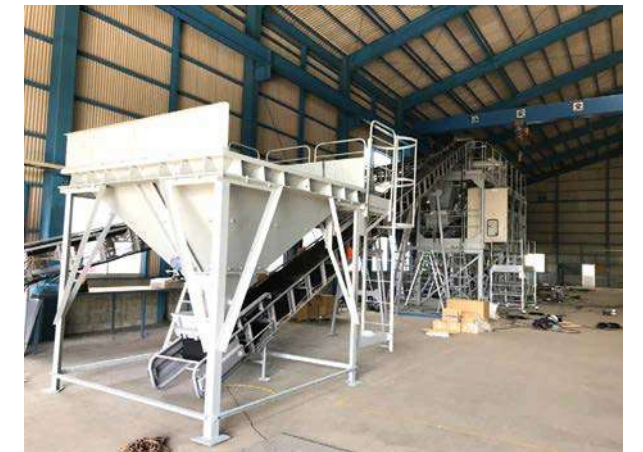
写真5: 骨材ホッパ、骨材計量ベルトコンベヤ
