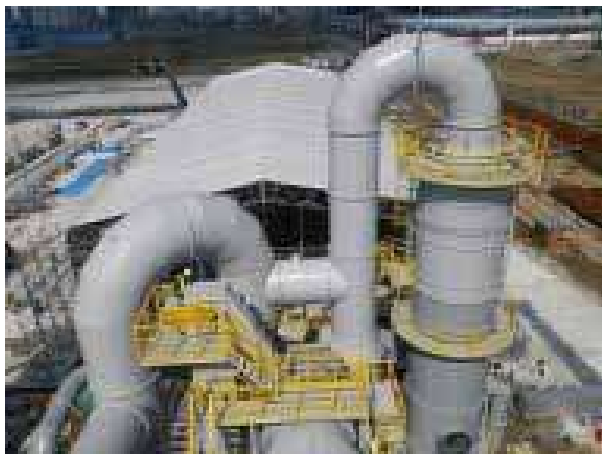
写真-20 左より、プレヒートキルン、熱交換器、冷却塔
