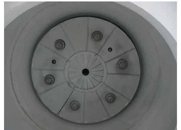
写真-18 NTR-StageⅥの一次処理装置用バーナの内部
