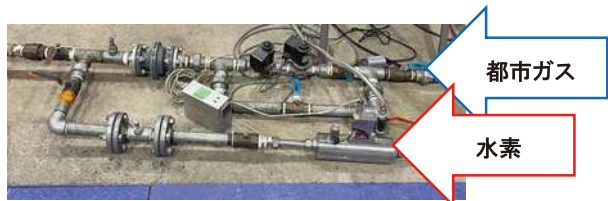
写真3-2 電磁弁ユニット
