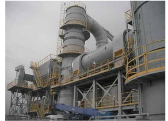
写真-13 NTR-Stage VIの一次処理装置とストックピン全景
