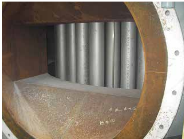
写真-16 NTR-StageⅥの熱交換器側面の受熱ガス導入口
