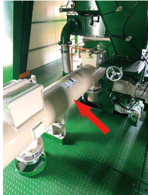
写真8バグから石粉計量器へ向かうダストフィーダ
