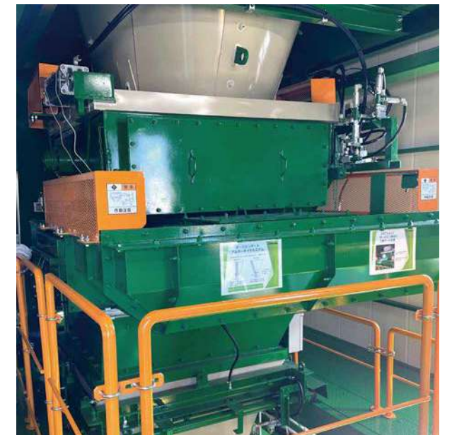
通常の扇型ゲートの下にスライドゲートを設けています
