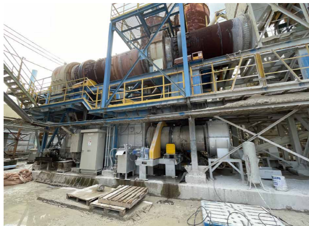
写真2-1 II型無水石膏製造設備
