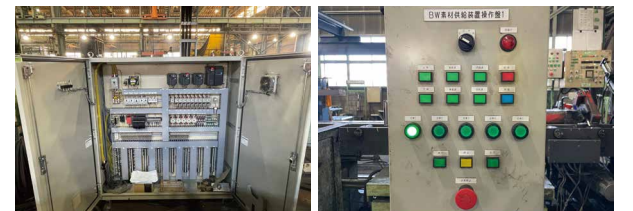
図11 制御盤 図12 手元操作スイッチ
