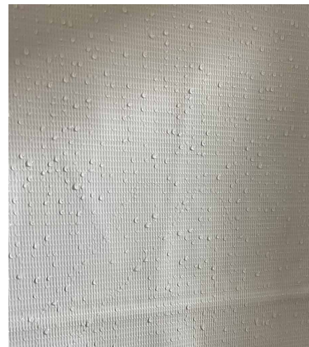
写真3 ハイドロヒート囲い内壁面
