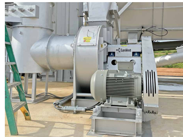
現地調達(Euro Ventの排風機)
