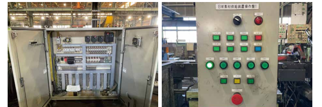
図11 制御盤 図12 手元操作スイッチ
